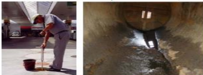
Figura 4 - Bomba em “T” e tanque em más condições.
